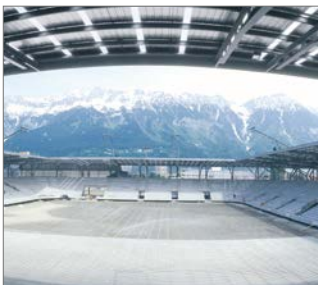
Ενδοδαπέδια θέρμανση γηπέδων - Στάδιο Tivol/ Innsbruck
